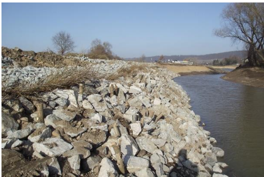
Foto 13: Begrünte Steinschüttung mit lebenden Pflöcken und Buschlagen sind für höhere hydraulische Belastungen geeignet. (Foto: STOWASSERPLAN)
