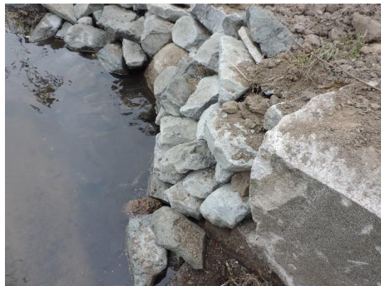
Foto 8: Ist der weitere Verfall der bestehenden Uferbefestigung nicht vorgesehen, so ist besonderes Augenmerk auf die Anbindung der neu profilierten Uferbereiche mit der naturnahen Ufersicherung an die weiter bestehende Ufermauer zu richten. (Foto: STOWASSERPLAN)
