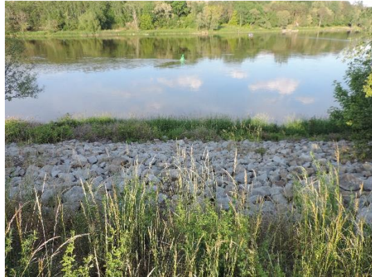
Foto 4: Ist der weitere Verfall der bestehenden Uferbefestigung nicht vorgesehen, so ist besonderes Augenmerk auf die Anbindung der neu profilierten Uferbereiche mit der naturnahen Ufersicherung an die weiter bestehende Ufermauer zu richten. (Foto: STOWASSERPLAN)
