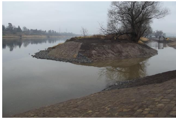
Foto 38: Der in der Vergangenheit verfüllte Elbseitenarm wurde wieder komplett freigelegt, aber nur im Bereich des Auslaufes mit dem Hauptstrom Elbe verbunden. Der Seitenarm füllt sich erst ab einer bestimmten Wasserspiegelhöhe mit Wasser. (Foto: STOWASSERPLAN)
