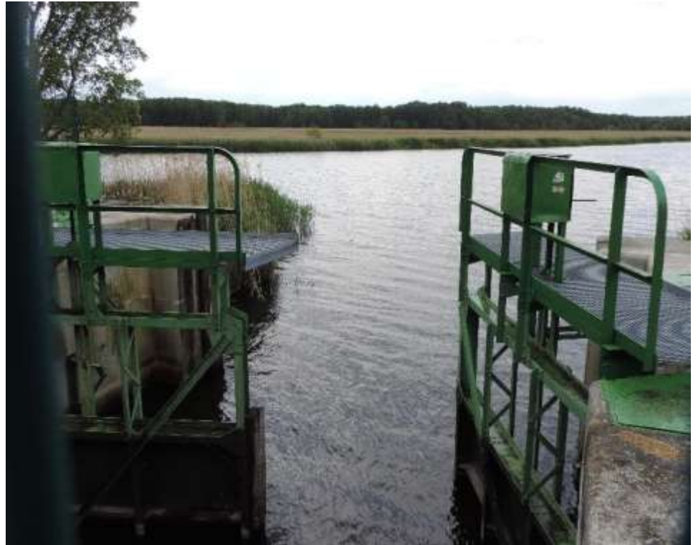
Abbildung 22: Sielbauwerk mit Schleuse bei Friedrichsthal
