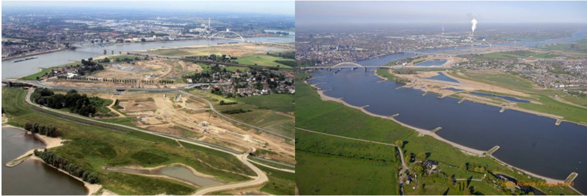
Abbildung 32: Deichrückverlegung und Nebengerinne Lent / Nijmegen (Waal-km 883) Situation vor (links) und nach (rechts) der Maßnahme (Fotos: Rijkswaterstaat)
