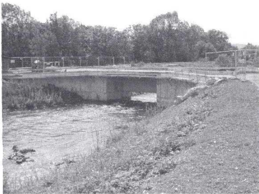
Bild 25: Traisen: Sohlstufe 40 - Drosselbauwerk
