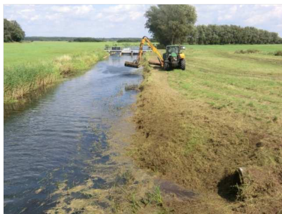
Abbildung 2-28: Böschungsmahd mittels Bagger mit Mähkorb an der Löcknitz uh. Wehr Jagel (Stat. 38+408)
