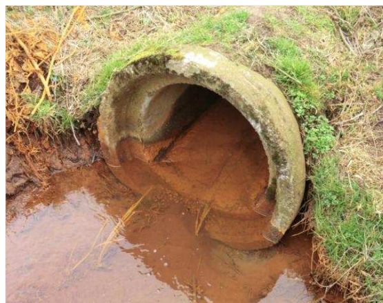
Abbildung 6-50: Starke Verockerungen am Boberower Graben (zw. Stat. 4+900 bis 5+300)
