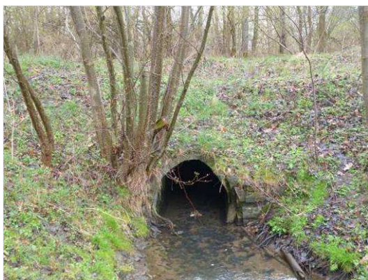
Abbildung 6-73: Bekgraben P07 (59324_539), Auslauf der Verrohrung
