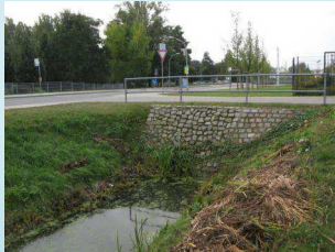
Rohrleitung Sportzentrum (km 8,3, BW10)
