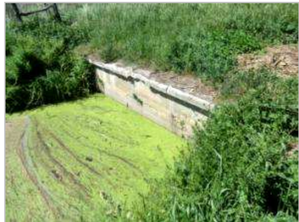
Abbildung 5-44: überstauter Plattendurchlass im Rhingraben
