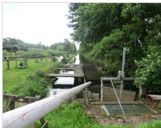
Abbildung 6-58: Bereich an der Goldbeck, parallel zum Angelteich in Platschow (zw. Stat. 7+700 und 8+300)
