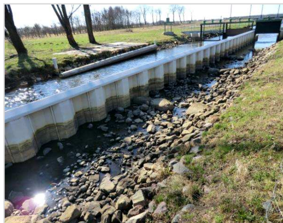
Abbildung 6-14: Wehr Jagel an der Löcknitz mit trocken gefallenem Fischauftiegsanlage (19.03.2012)
