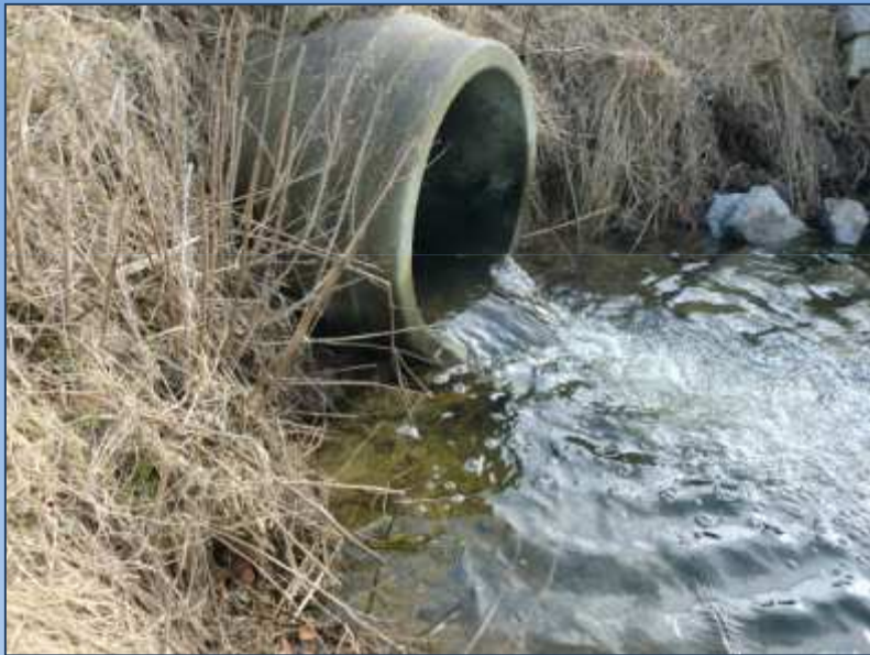
Durchlass ohne Substrat, mit Absturz
