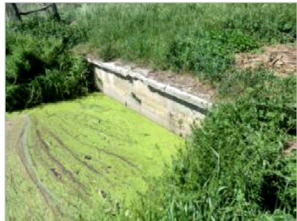
Abbildung 5-44: überstauter Plattendurchlass im Rhingraben
