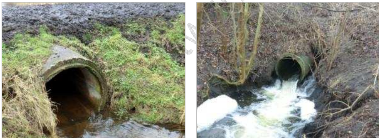
Abbildung 5-40: Links Rohrdurchlass ohne Substrat auf der Sohle, rechts unüberwindbarer Sohlspünge
