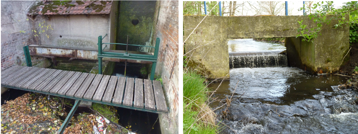
Abb. 37: Während die Herstellung der ökologischen Durchgängigkeit an der Lieberoser Mühle (links) technisch eine besondere Herausforderung darstellt, ist der Umbau kleinerer Staustufen wie an der Voigtsmühle (Samgase, rechts) relativ unkompliziert
