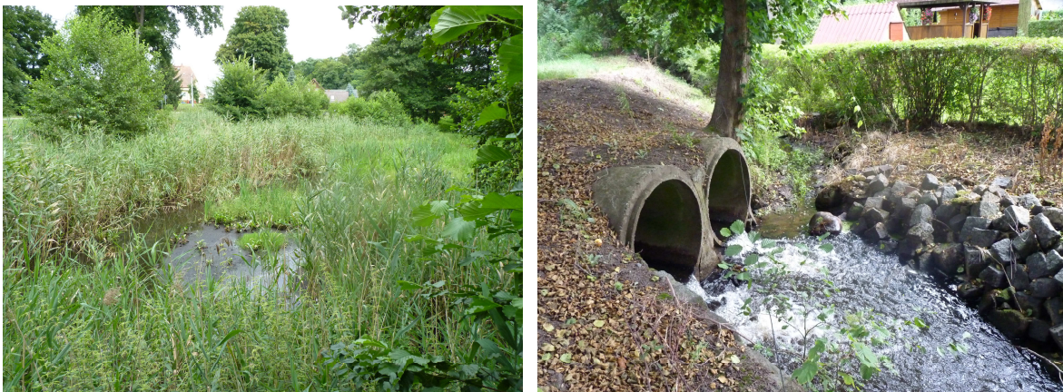
Abb. 35: Teich in Lamsfeld (links) mit dem unüberwindbaren Sohlabsturz (rechts). Hier ist eine Fischwanderhilfe als Umgehungsgerinne geplant
