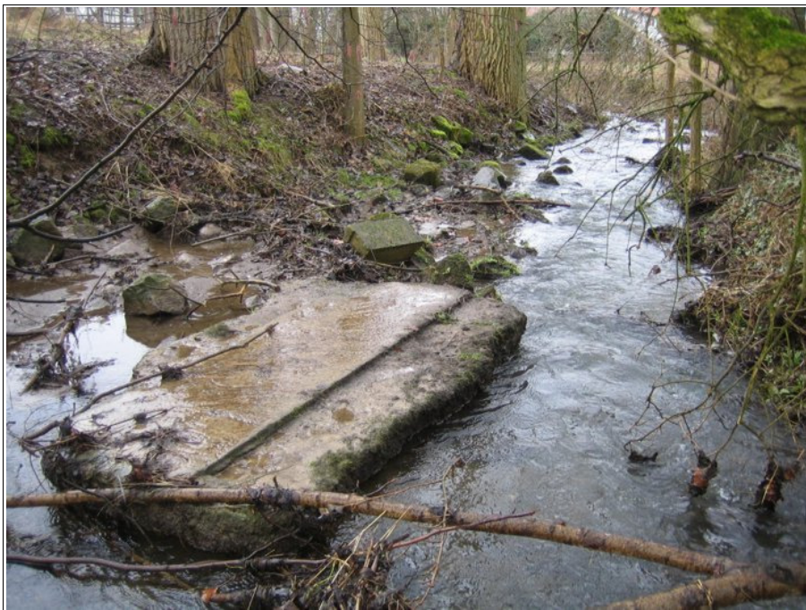
Abb. 2: Ins Gewässer gestürzte Teile der Mauer
