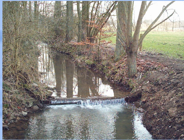
Grundschwelle S 20/1 (KP)
