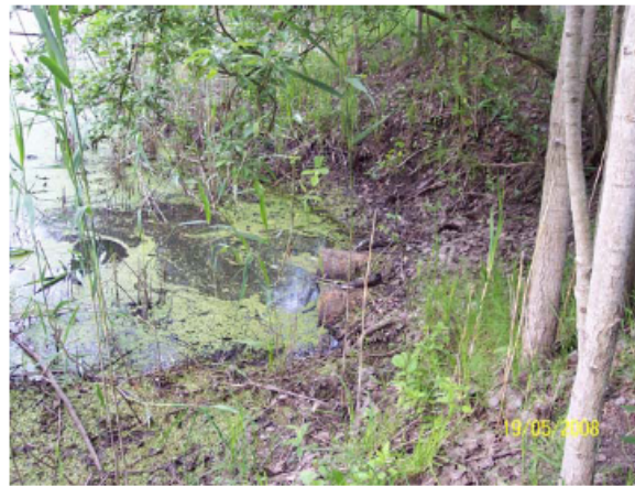
Rohrdurchlass 2x Stahl DN 500 im Unterwasser
