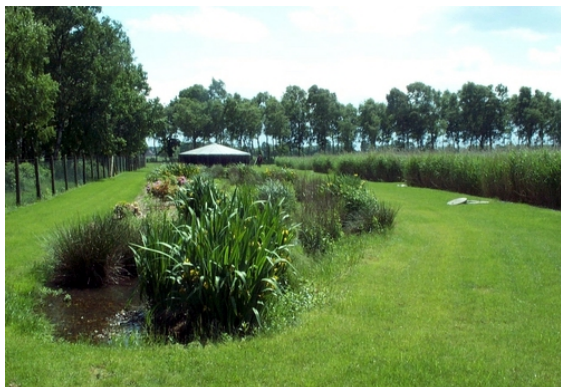
Abb. 24: PKA zur Reinigung und Hygienisierung der Badewässer aus einem Naturbad, zur Verfügung gestellt von der Fa. Eko-Plant
