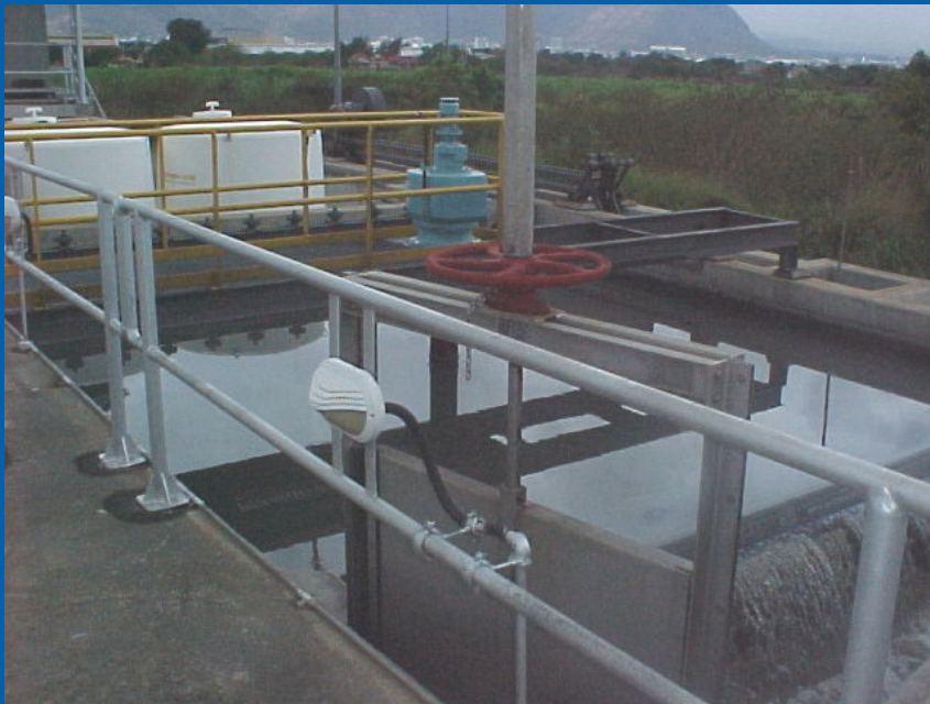
Abwasserreinigungsanlage Baie du Tombeau
