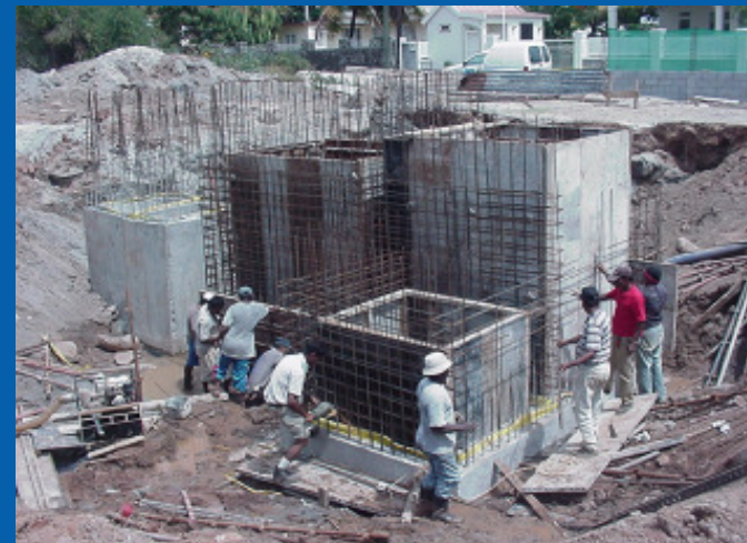
Pumpstation Baie du Tombeau
