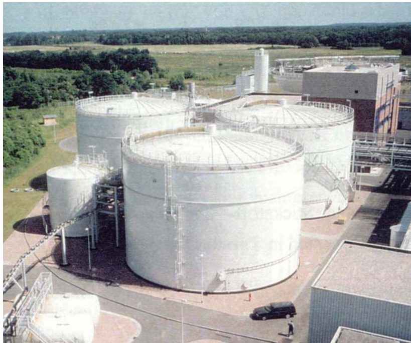
Abbildung 3: Abgedeckte Stapelbehälter der Kläranlage A
