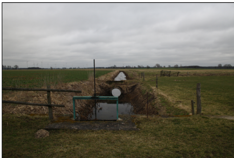
Abbildung 17: Nicht durchgängiger Fließgewässerabschnitt des Söllenthingrabens bei km stat. 00+900 (Foto: FuK, 12.03.2012)
