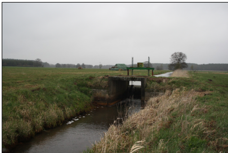
Abbildung 16: Nicht durchgängiger Fließgewässerabschnitt der Karthane bei km stat. 41+200 mit einem hohen Absturz durch die Stauhaltung (Foto: FuK, 07.04.2012)
