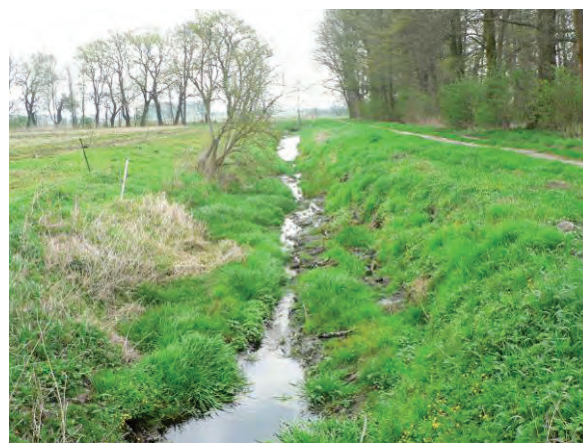
Abbildung 74: Beidseitiger Böschungsabbruch bei 0+650
