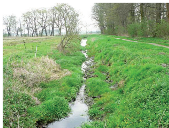
Abbildung 74: Beidseitiger Böschungsabbruch bei 0+650
