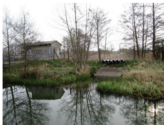
Abbildung 33: Pumpwerk in den Königsgraben
