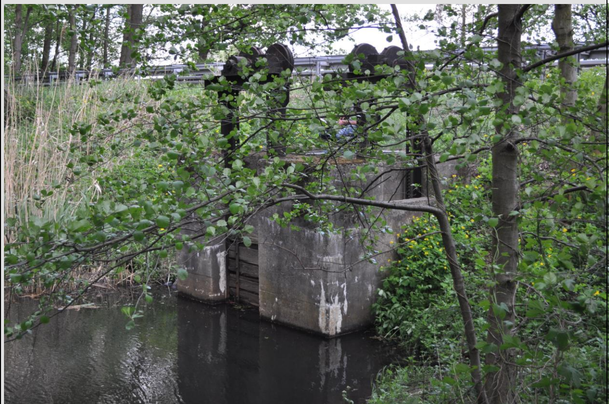
Abbildung 11: Zustand des Einlaufbauwerkes zur Pretschener Spree im Juni 2012
