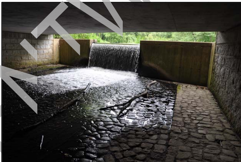
Abbildung 6: Wanderhinderniss und Sedimentfalle am Cederbach in Hoppenrade, km stat. 13+900 (Foto: FPB GmbH, 06.06.2012)
