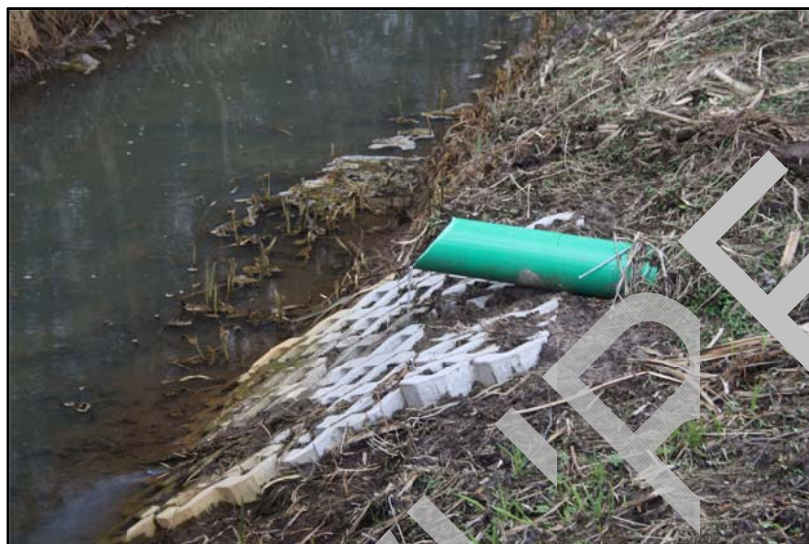
Abbildung 3: Draineinleitung am Wildwestbach bei km stat. 01+250 (Foto: FuK, 15.03.2012)
