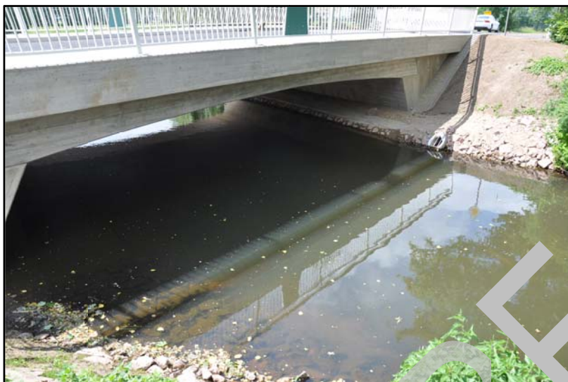
Abbildung 1: Regenwassereinleitung an der neugebauten Straßenbrücke am Ortseingang Bad Wilsnack bei km stat. 16+800 (Foto: FPB GmbH, 30.05.2012)
