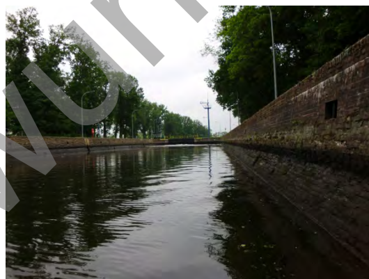
Abbildung 78: Abschnitt P06, total verbauter Gewässerlauf im Schleusenbereich Garz
