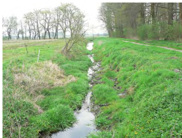
Abbildung 64: Beidseitiger Böschungsabbruch bei 0+650
