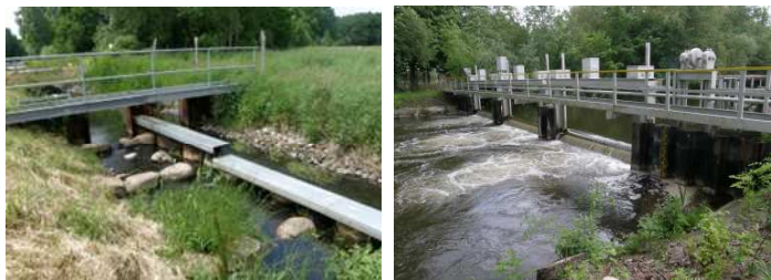
Wehr mit integrierter Fischaufstiegsanlage im Rottstocker Kanal (li); Wehr Blankensee ohne Möglichkeit für Fische auf- oder abzuwandern (re)
