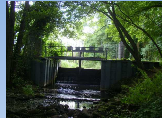
Nieplitz, Wehr Buchholz: Durchgängigkeit über vertikale Zweiteilung, ein Feld offen. Wehr muss regulierbar, funktionstüchtig und gewartet sein, um es im Hochwasserfall schließen zu können.
